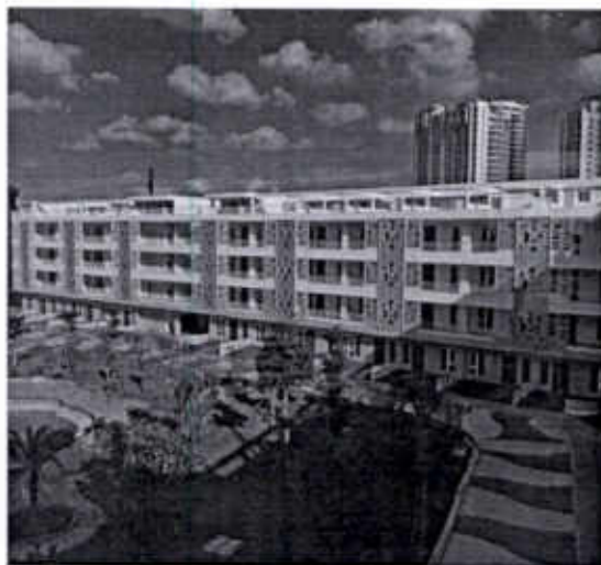
Lakeview 1: Khu nhà 4 tầng đã hoàn thành phần thô, đang thi công hoàn thiện
